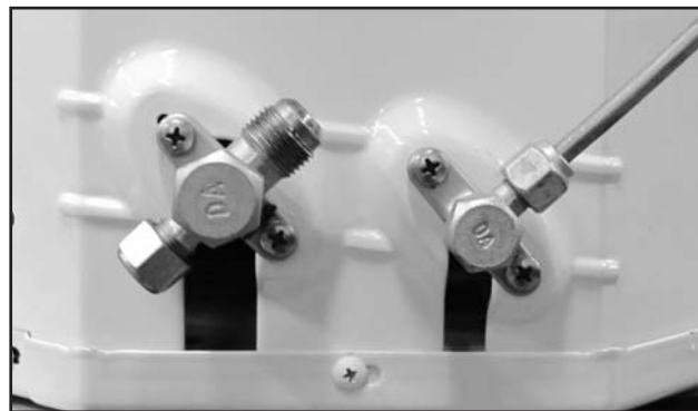
FIG. 46 - CONEXÃO DA LINHA DE EXPANSÃO DA UNIDADE CONDENSADORA
